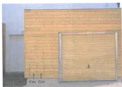
Coffrets techniques intégrés à la façade du garage
